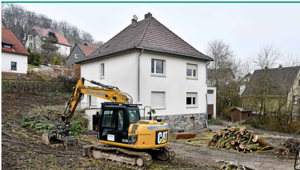
Das Pfarrhaus der evangelischen Kirchengemeinde Ihmert wird abgerissen und durch Wohnhäuser für Familien ersetzt. Foto: Ralf Engel / Iserlohner Kreisanzeiger und Zeitung
